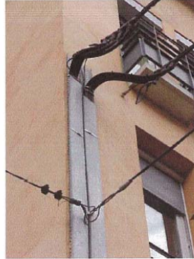
Remontée de câbles d'injection en façade dans une goulotte de protection
